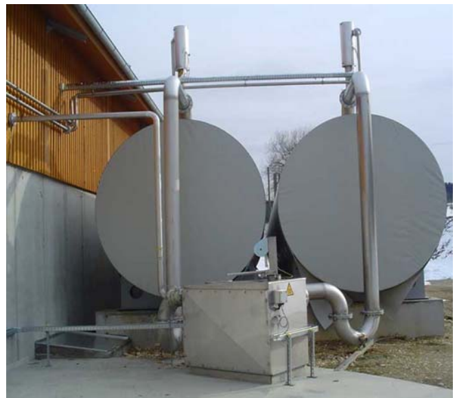
Abb. 1: Eine Biogasanlage in Oberösterreich.
